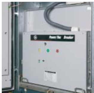
断路器在柜内试验位置
