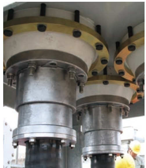
110kV GIS终端安装在武钢
