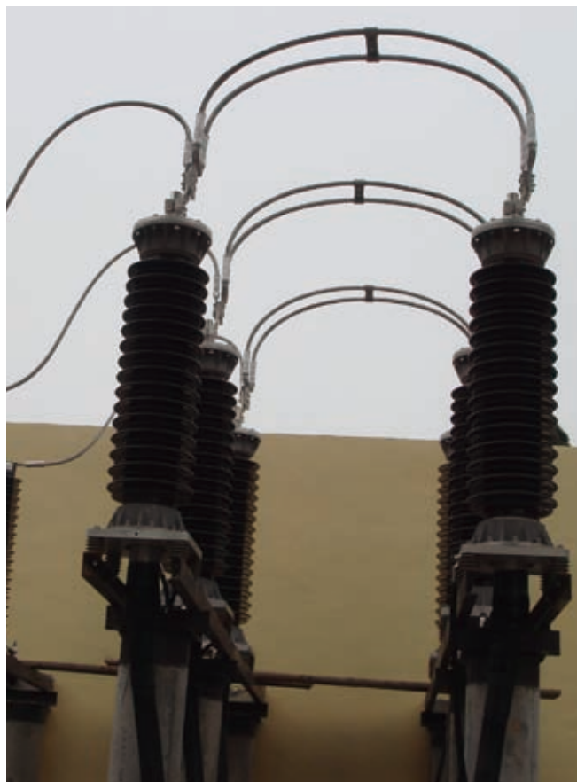
110kV瓷套绝缘OHVT安装在天津供电局
