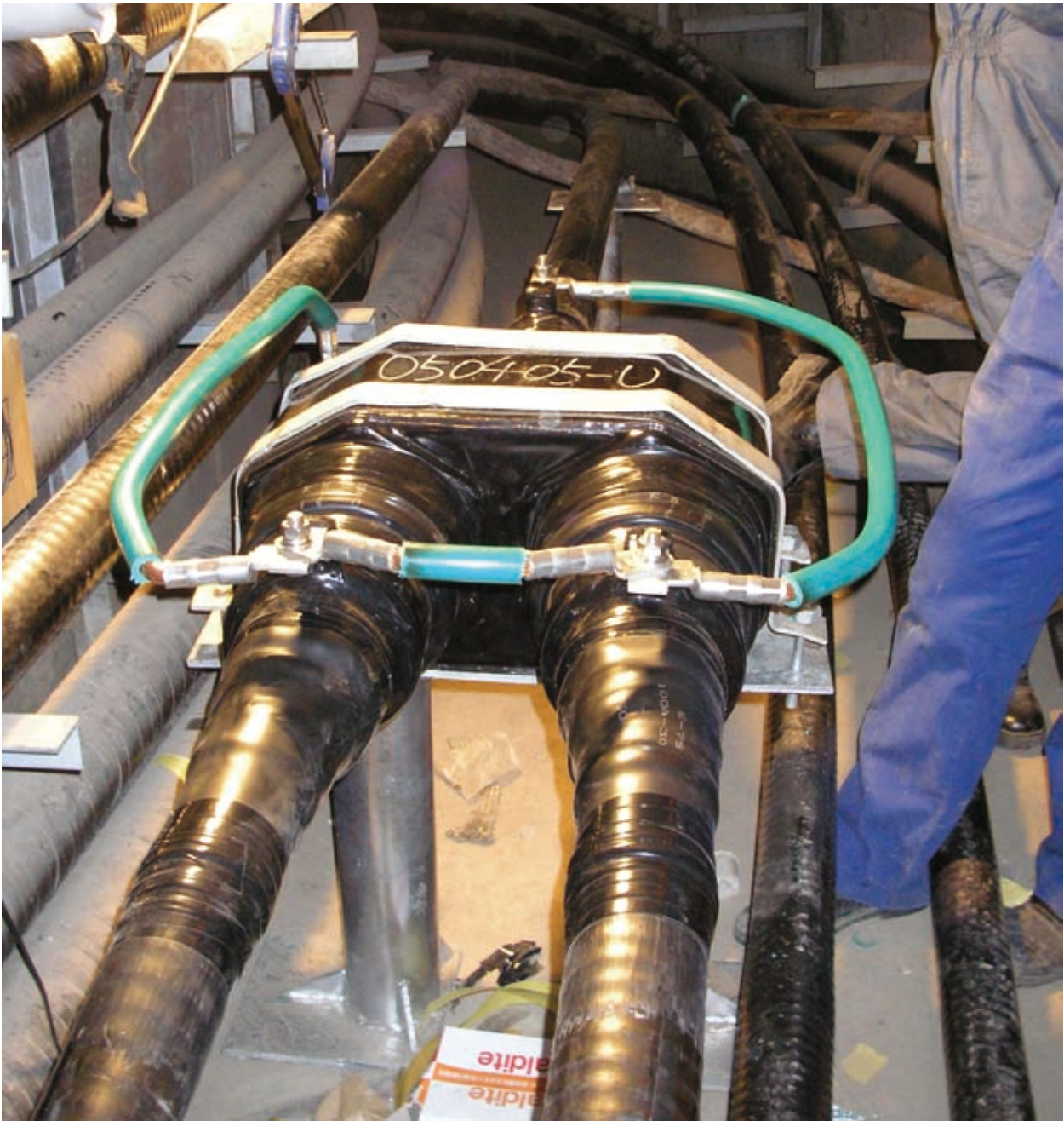
Y接头安装在长春供电局
