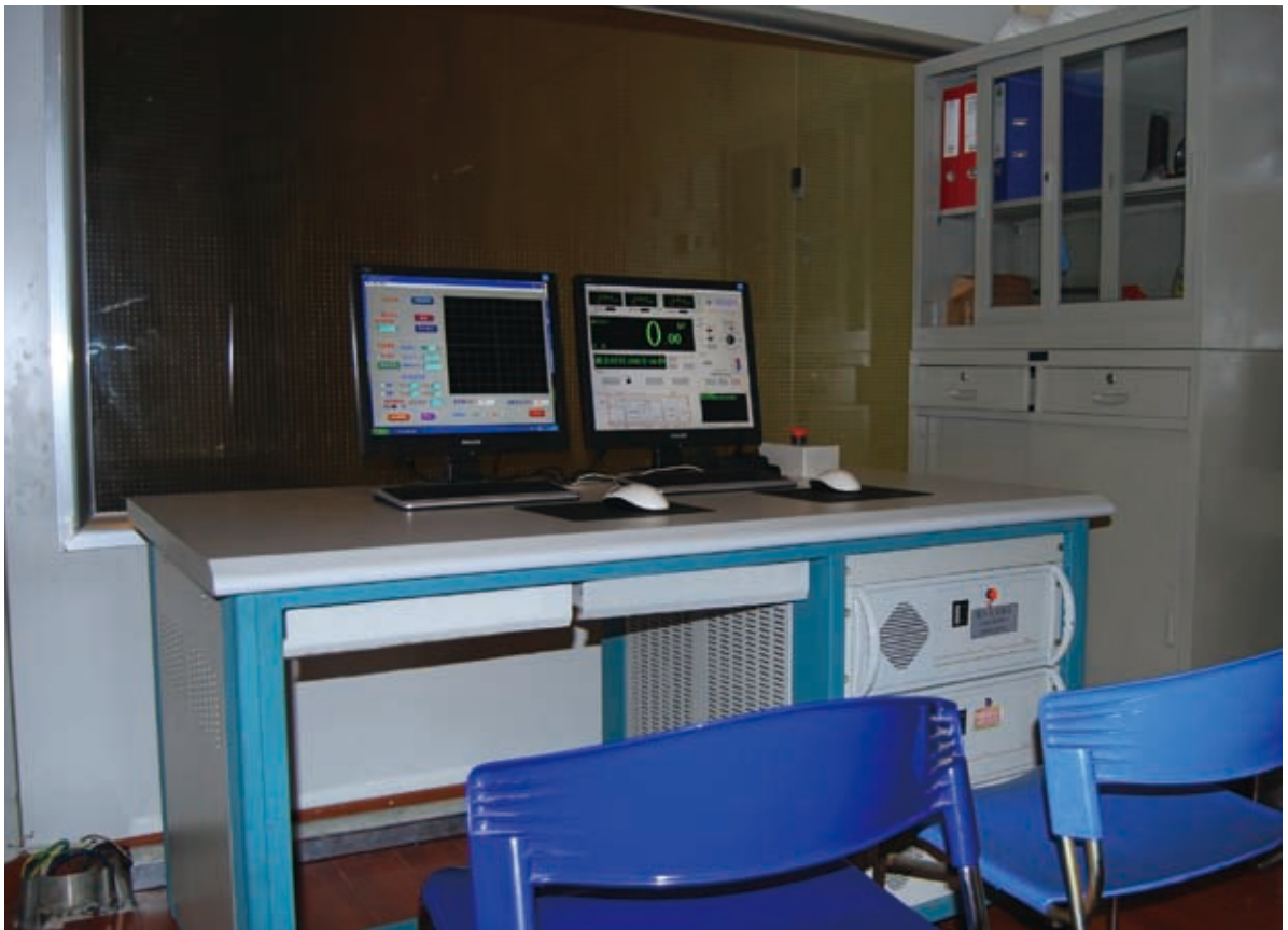
昆山工厂局放测试设备
