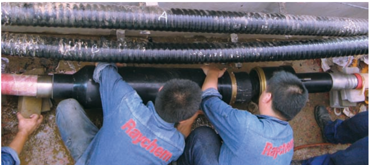
110kV中间接头安装在武钢
